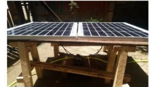
(d) Solar Panels
